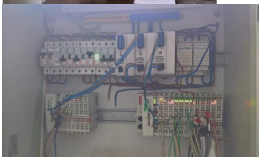
Szafa sterownicza ze sterownikiem PLC i elementami zabezpieczającymi
