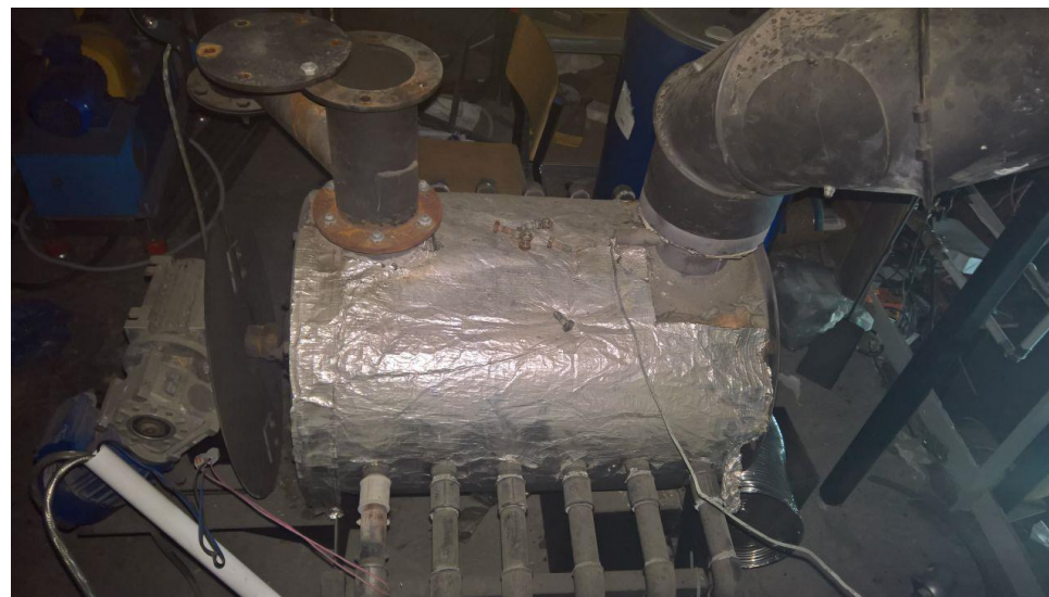
Piec ceramiczny z rusztem obrotowym do utylizacji odpadów
